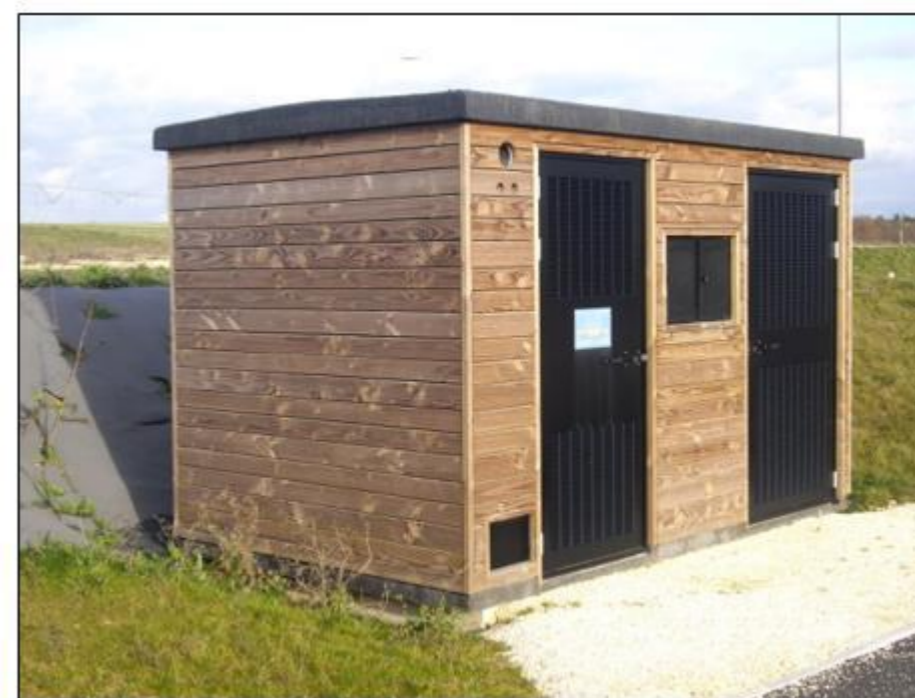
Illustration 12 : Exemple de poste de livraison
