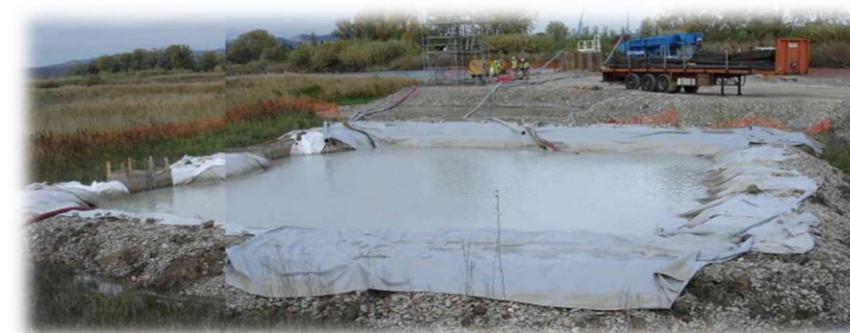
Illustration 187 : Bassin provisoire de décantation des MES et autres polluants (Source photo : ADEV Environnement)
