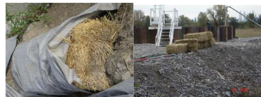
Illustration 186 : Filtres à pailles (Source photo : CETE)
